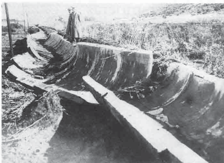
Afb. 2. Een door overstroming vernield irrigatiekanaal.
