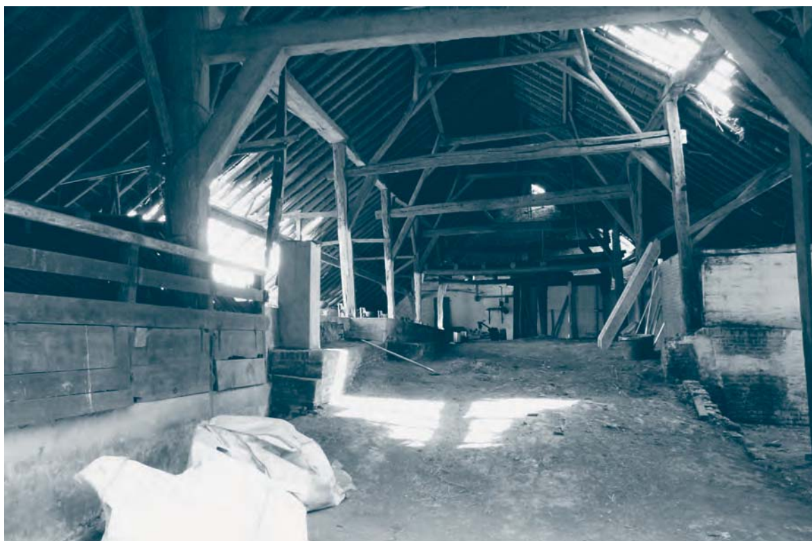
Afb. 5. Burggraaf 6, Meerkerk: in de boerderij is een waterstal op een aarden bult aanwezig. Door het oplopende talud konden de koeien naar de stal. Fotoarchief Rijksdienst voor het Cultureel Erfgoed.
